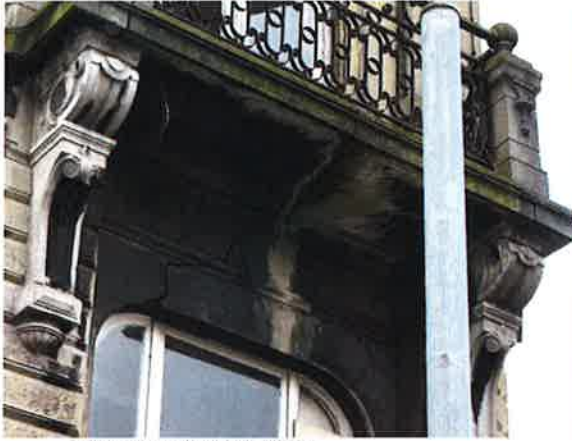
Photo 3 : Fissure au droit d'un linteau
