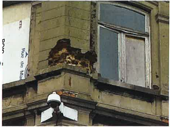
Photo 4 : Décollement de briques
