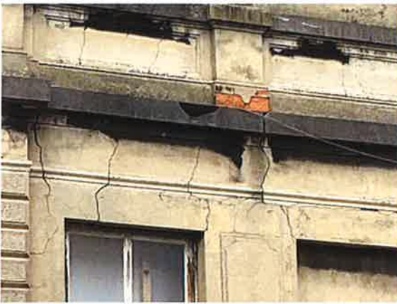
Photo 5 : Fissures au droit de linteaux de fenêtre
